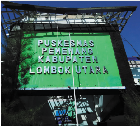
Kondisi Puskesmas Pemenang setelah terdampak gempa.
