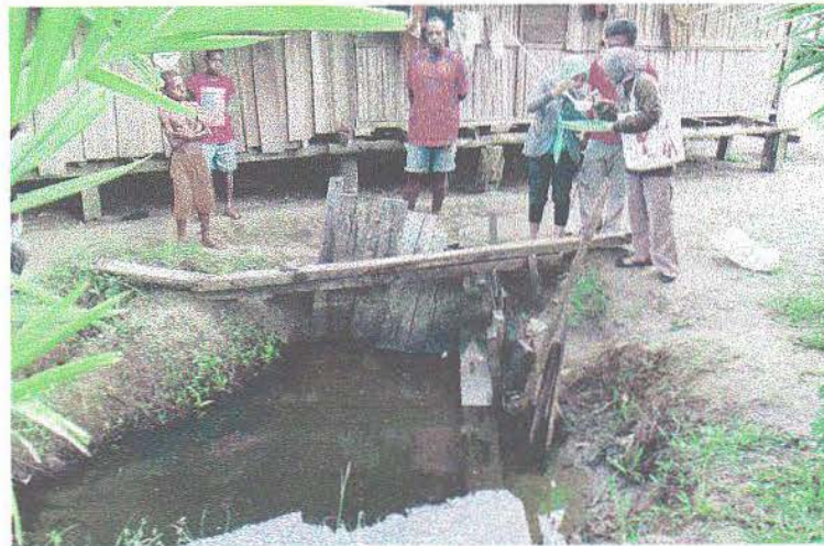
2.1 Kolam penampungan air di Kampung Amsira, Kab. Sarmi.
